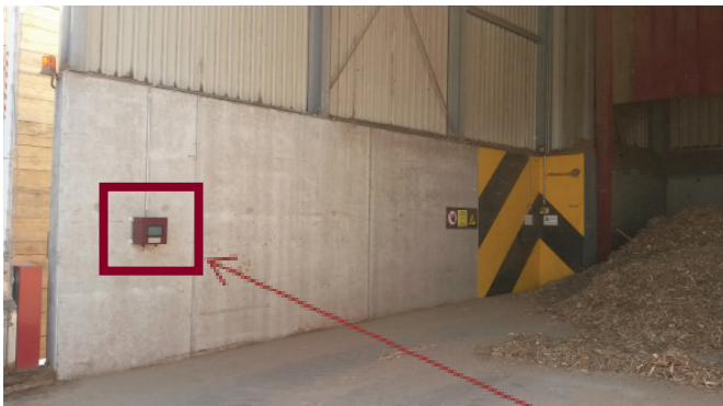
Bunkeranlage Kronospan Sandebeck mit APOS Bedienterminal
