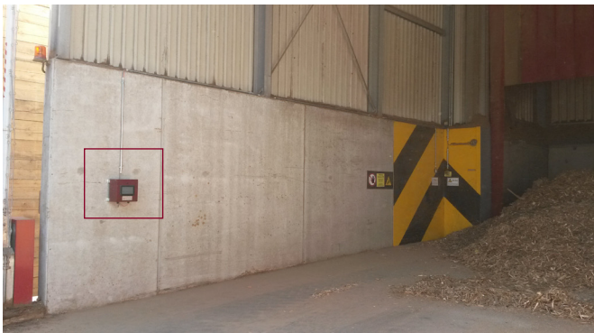
Bunkeranlage Kronospan Sandebeck mit APOS Bedienterminal
